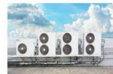
Промышленная вентиляция и кондиционирование
